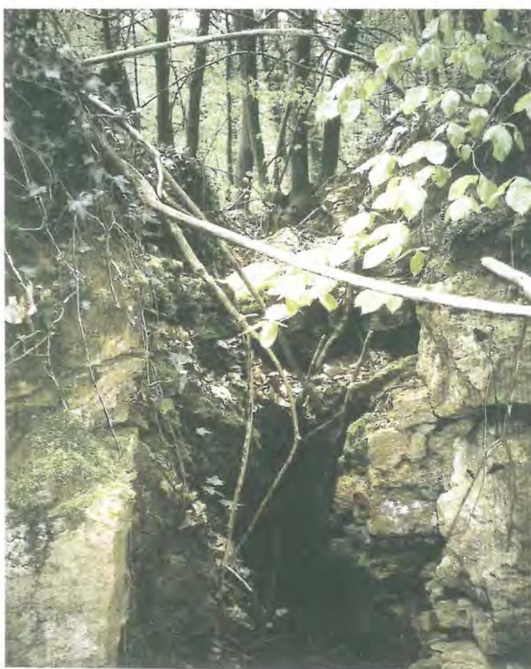
Photo 29: Crevasse du site Grand Bois "bouchée" à faible profondeur par la végétation et les matériaux de glissement (A. Storoni, mai 2000)
