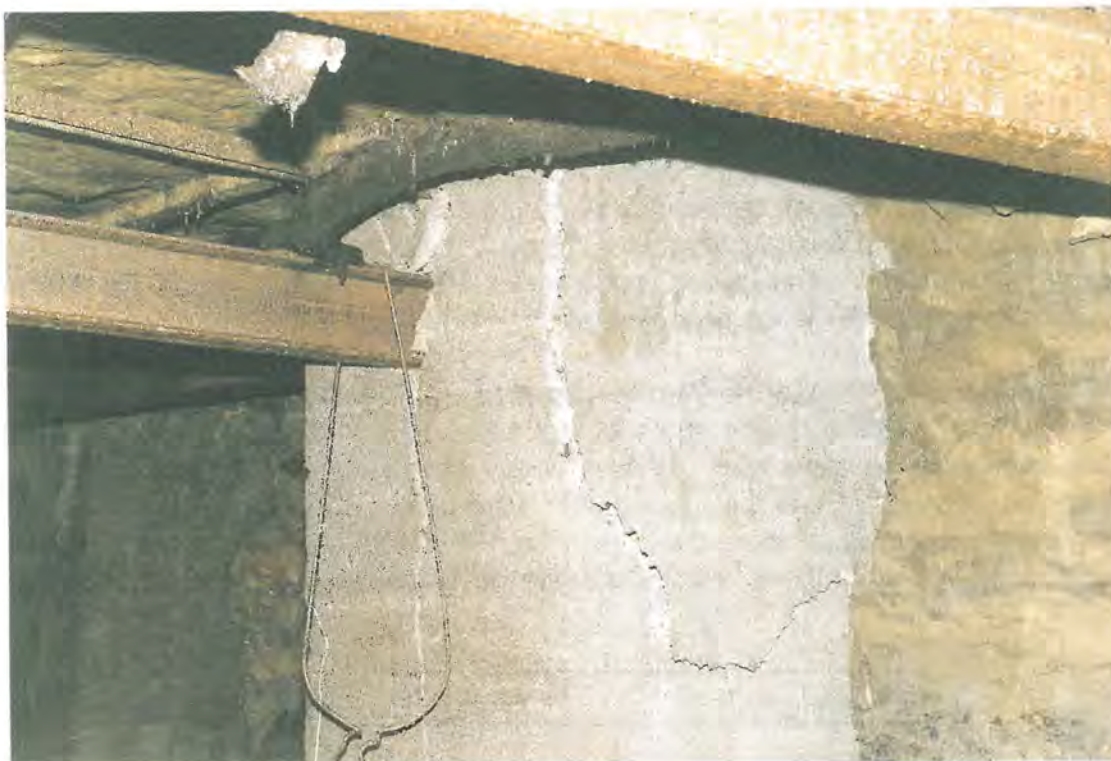
Photo 37: Effets des forces de cisaillement sur un pilier en béton, abandonné depuis une trentaine d'années dans la mine Thy-le-Château près de Rodange (A. Storoni, mai 1995)
