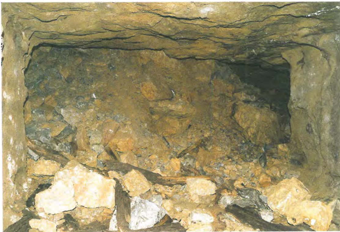
Photo 22: Effondrement du toit et épanchement des roches, dans la mine Dhoil près de Rodange (Photo A. Storoni, mai 1995)
