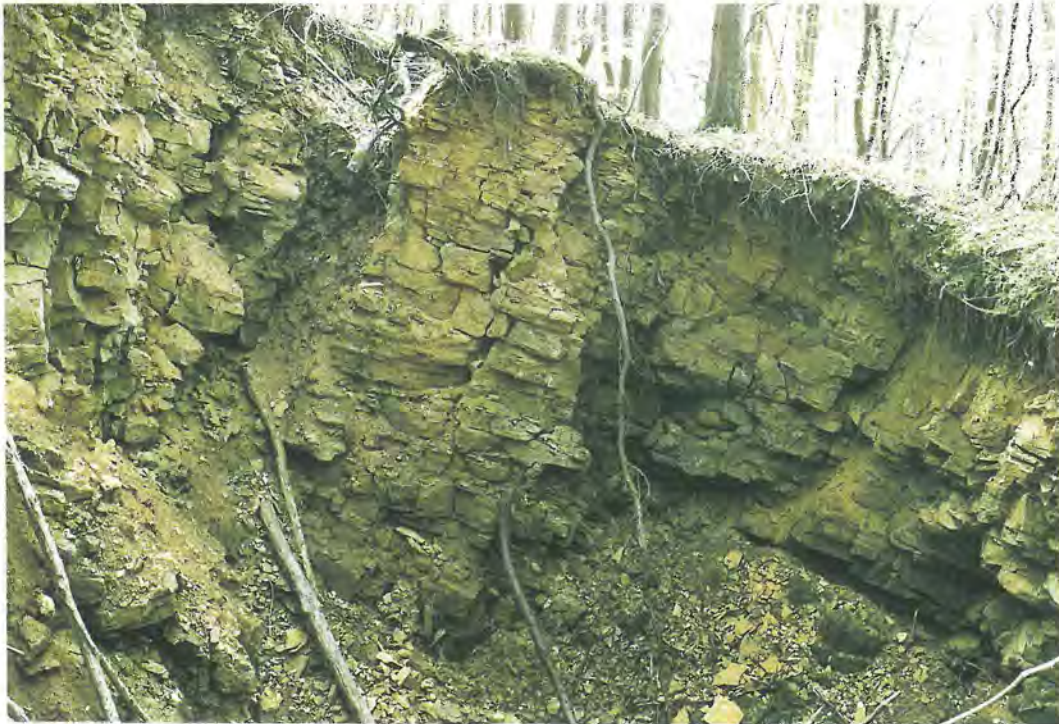
Photo 14: Crevasses apparaissant au sommet de la paroi de l'entonnoir-puits n° 8 du site Kalebiery (Photo A. Storoni, septembre 1999)
